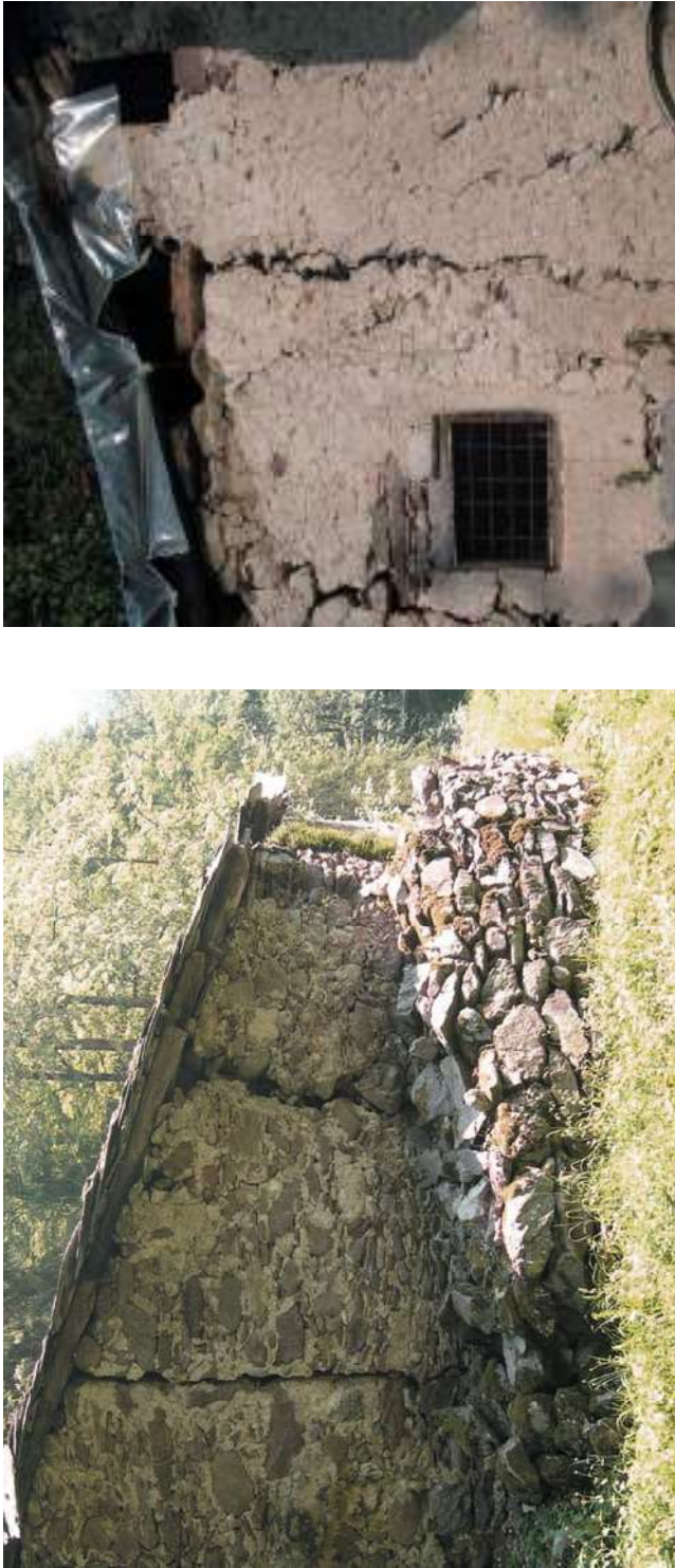
alcuni esempi del fenomeno di degrado
